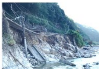
JR山陽線 盛土崩壊・土砂流入 (平成30年 7 月豪雨による被害)
