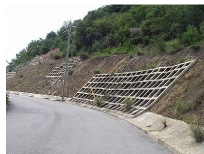
写真1 緑化が乏しく地山がむき出し
