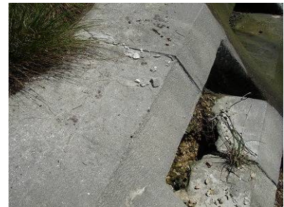
写真5 のり枠背面が洗堀さ
