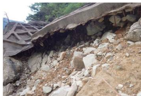
写真 2 現地状況（背面地山の侵食・抜け出し・吹付砕工の浮き上がり【施工後 15 年経過】）
