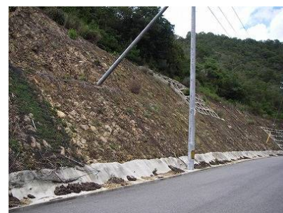
写真2 基盤材がはく落
